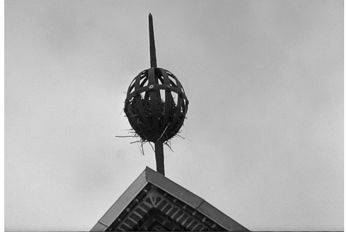
Skaderede i gavlprydelse, Østerbrogade, marts 2001. Gavlprydelsen er desværre siden blevet foret med kyllingetråd, så skaderne ikke kan komme ind.
